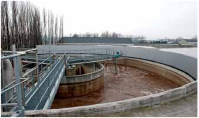
Bijzonder aan het 'Blue Hero'-concept is dat de 'effluenttank' van het biologische zuiveringsstelsel wordt gebruikt.
